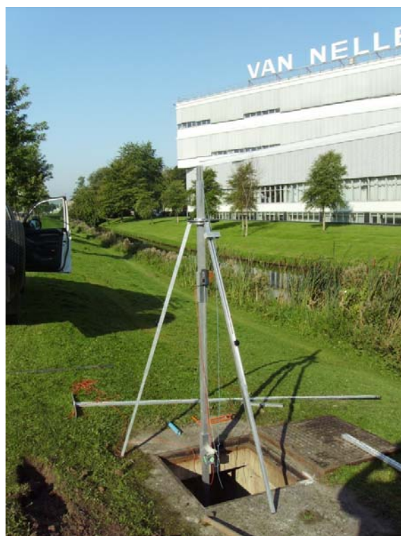
Inmeten van rioolputten zonder af-dalen van mensen, i.v.m. risico van gevaarlijke gassen.
