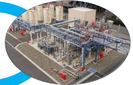
【 Kawasaki Dehydrogenation Plant】
