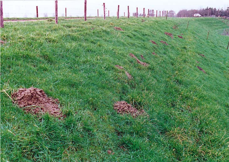
Foto b5.23 Molshopen op binnentalud tijdens hoogwater 1995, rechteroever van de Maas (DP 77) te Overasselt. [RWS/DWW]
