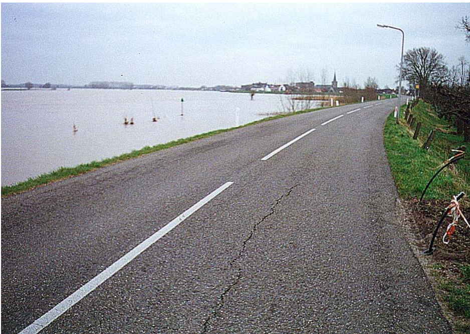
Foto b5.15 Scheurvorming in wegdek ten gevolge van onvoldoende stabiliteit tijdens hoogwater op 2-2-1995, dijk tussen Ameide en Tienhoven (DP29). [RWS/DWW 907/29]
