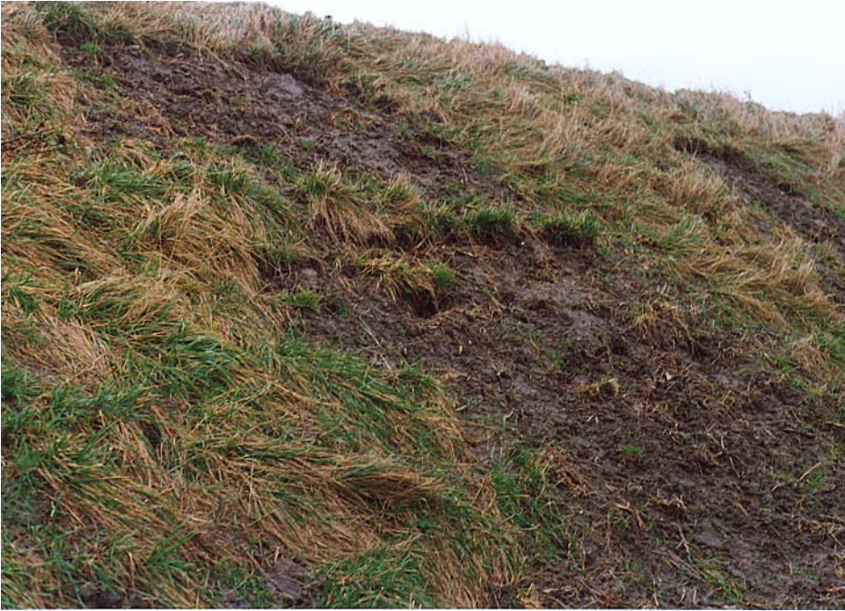
Foto b5.11 Erosie buitentalud [RWS/DWW 825/181t]
