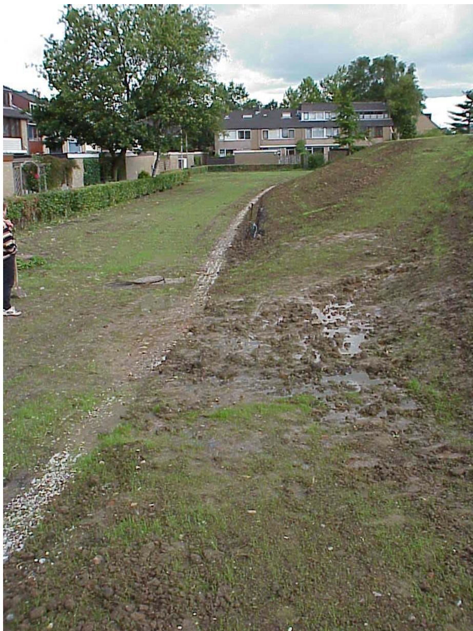
Foto b5.25 Natte plekken aan de binnenteen van een hoofdwaterkering in het benedenriviereengebied [Arcadis]
