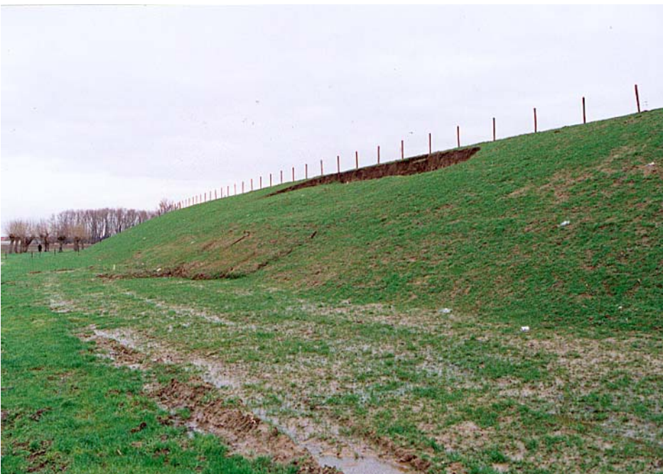
Foto b5.12 Ondiepe afschuiving buitentalud na hoogwater, Wijk en Aalburg, 100 meter noordelijk van de brug over het Heusdens kanaal. [RWS/DWW 833/6]
