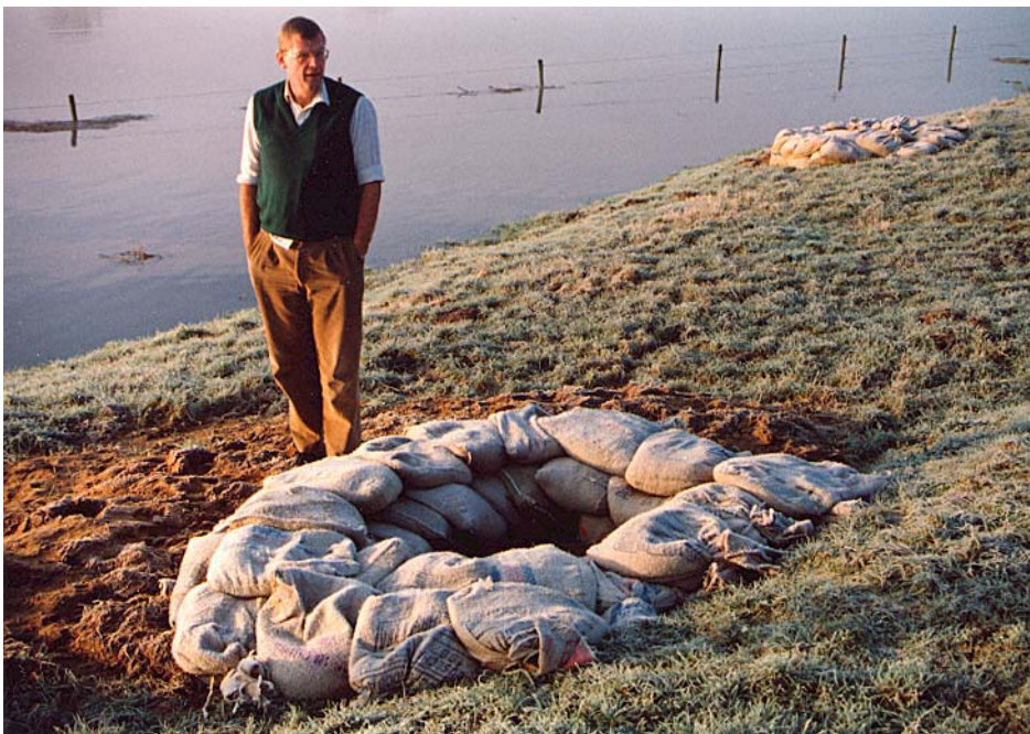
Foto b5.24 Dassenhol in dijktalud tijdens hoogwater van 1993, rechteroever van de Maas (DP 79) te Overasselt. [RWS/DWW]
