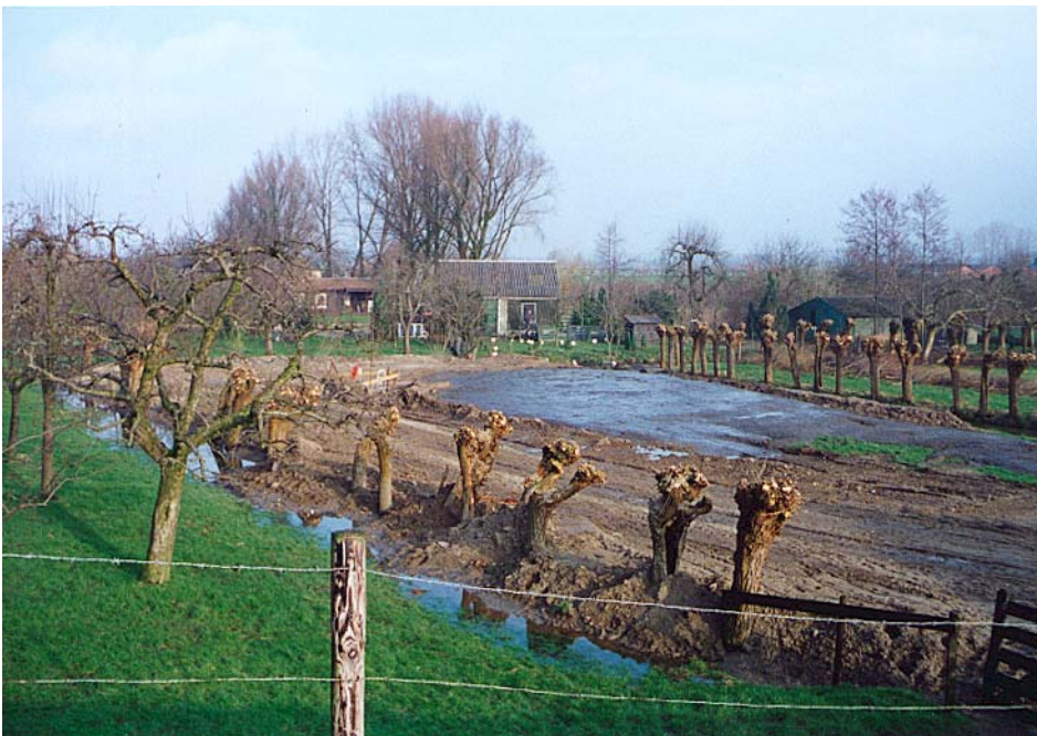
Foto b5.16 Opbarsten binnendijks maaiveld tijdens hoogwater van 1995, Lek, linkeroever (DP36) te Lexmond. (Noodvoorziening. Wellicht gevaarlijkste schade van 1995) [RWS/DWW 907/14]
