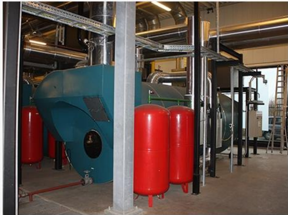
Bestaande Gasketel 1 (4,9 MWth)
