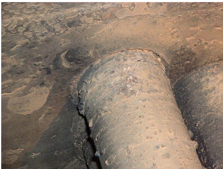
Pijp waarbij spleetcorrosie is opgetreden. Bij deze ketel hebben we 140 vlampijpen moeten vervangen.
