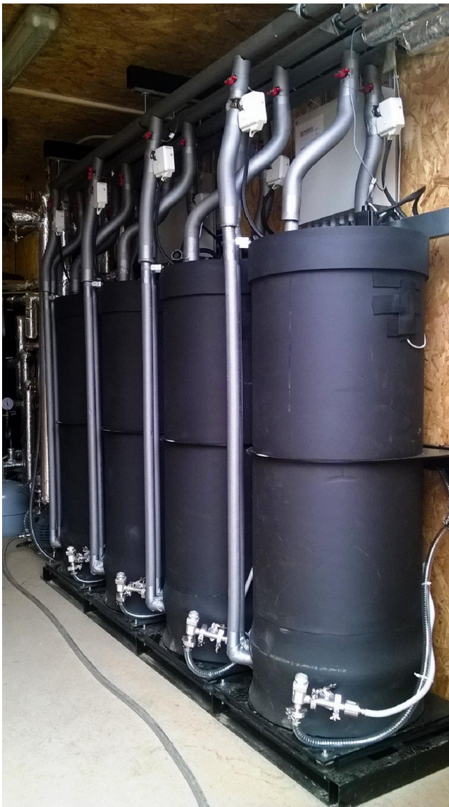
De warmtebatterij heeft vier reactoren.
