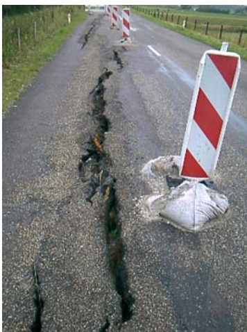
<Figuur 6: Foto van scheuren in primaire waterkering >
