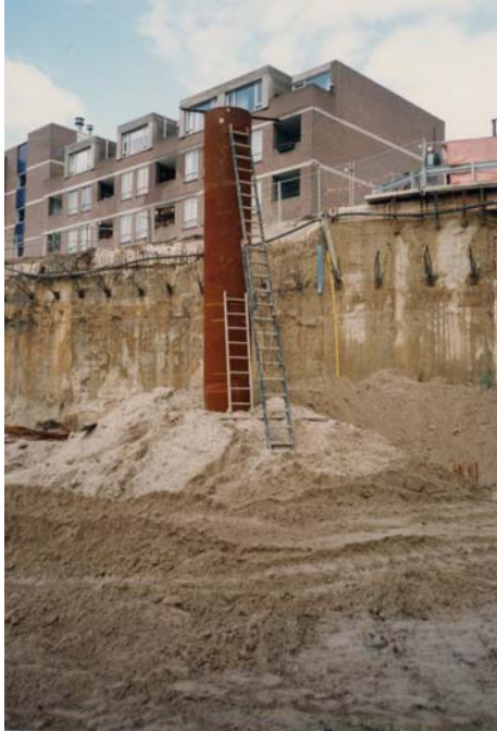
<Figuur 5: Door tijdig een stalen buispaal over de wel aan te brengen kon hier erger worden voorkomen>
