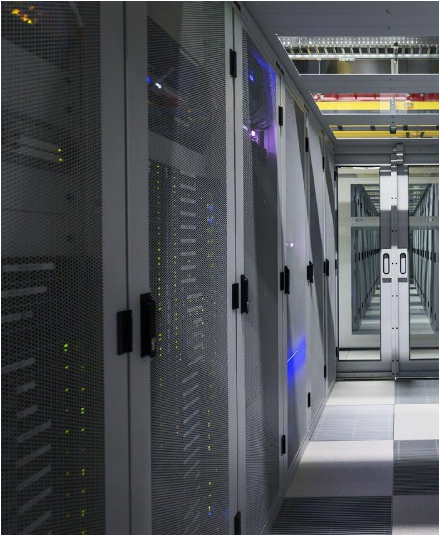
Equinix Datacenter in Amsterdam. Foto: Olivier Middendorp/HH
