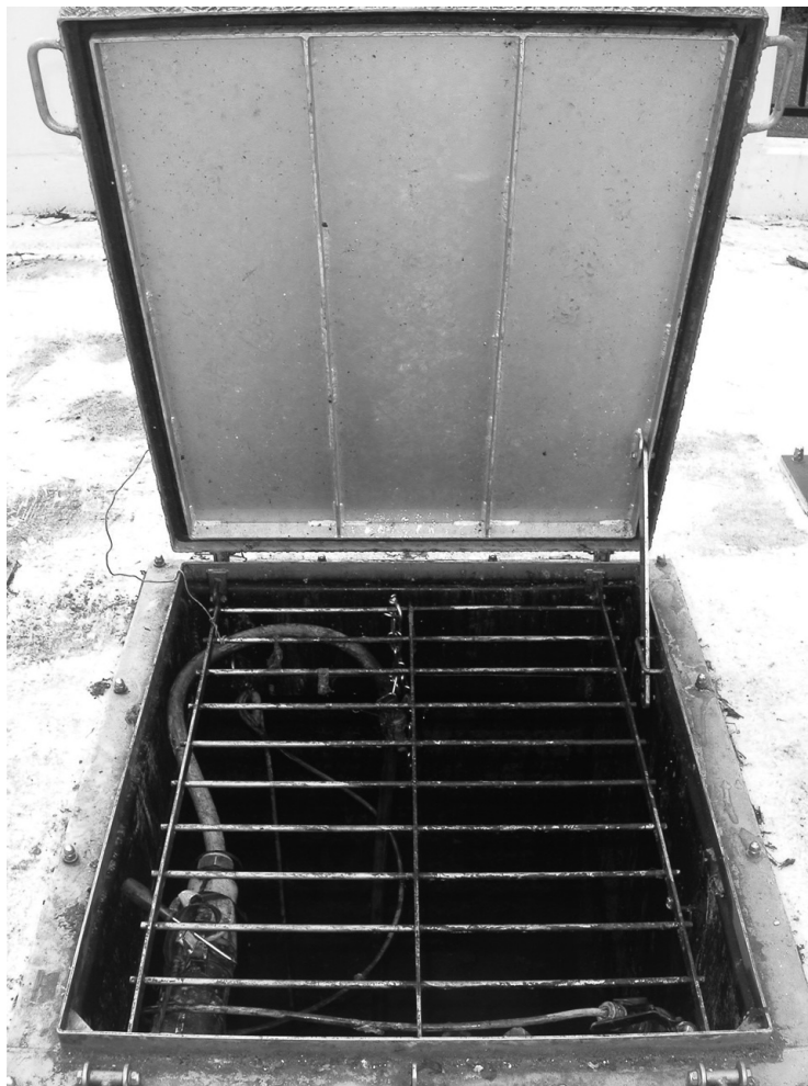
Figuur 6.60 Valbeveiliging onder hijsluik vuilwaterkelder
