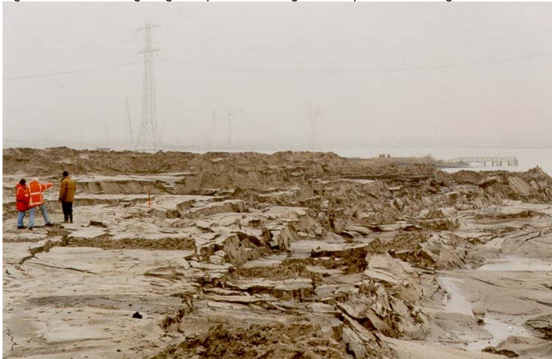
Figuur 3-6 Taludinstabiliteit Noordwest punt Haveneiland, 24 november 1999, (Foto: E.P.T. Smits)
