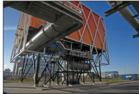
Air cooled condenser + opbouw
