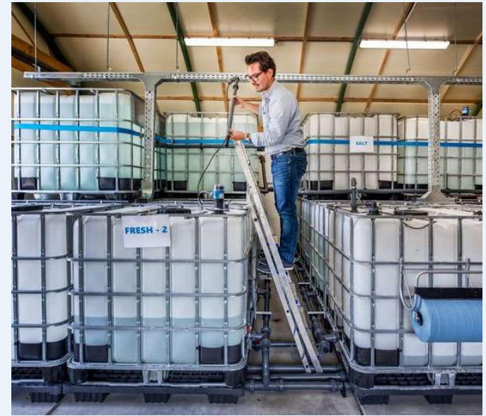
Zout water batterij Blue battery bij AquaBattery (foto Volkskrant)
