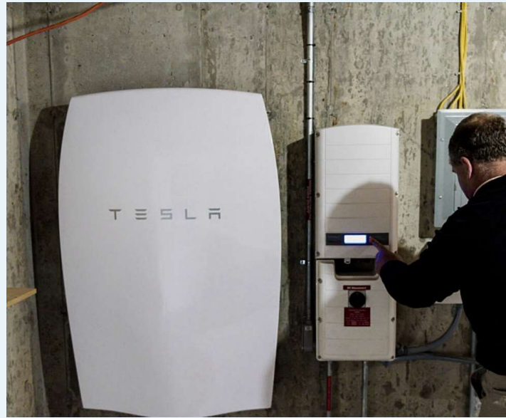
Elektrische batterij Powerwall van Tesla
