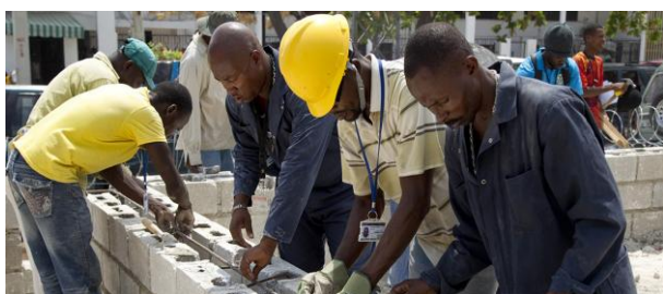
Figuren 1 en 2: Bouwvakkers in Swania. Helmen, handschoenen, hesjes, beschermende kleding ontbreken. De man met helm en handschoenen is de leidinggevende. Foto's World Bank.
