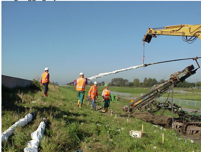
Figuur 6. Het inbrengen van een kous in een boorgat onder het weglichaam. Rechts is de groutankermachine die de boorgaten heeft gemaakt.
