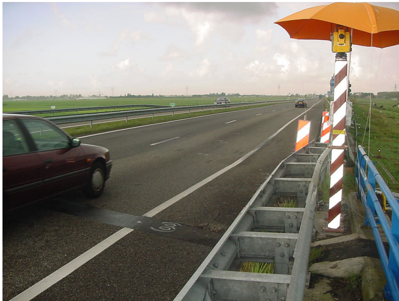
Figuur 1. Het te onderhogen gedeelte van de noordelijke rijbaan van de N11. De kromming van de rechterkantstreep duidt op een kuil in het asfalt.
