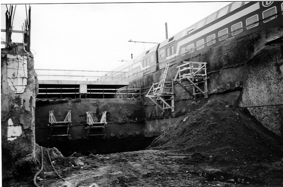
Figuur 2: Vernagelde wand in aangevulde gronden, die plaatselijk losgepakt zijn, voor de Noord-Zuidlijn onder Antwerpen.
