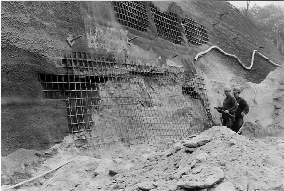
Figuur 1: Problemen bij de uitvoering van een vernagelde wand in Brusseliaans zand
